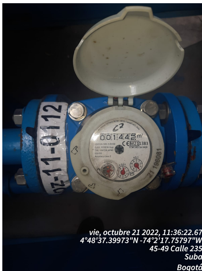
Fotografía 7. Medidor volumétrico instalado en el pozo pz-11-0112
